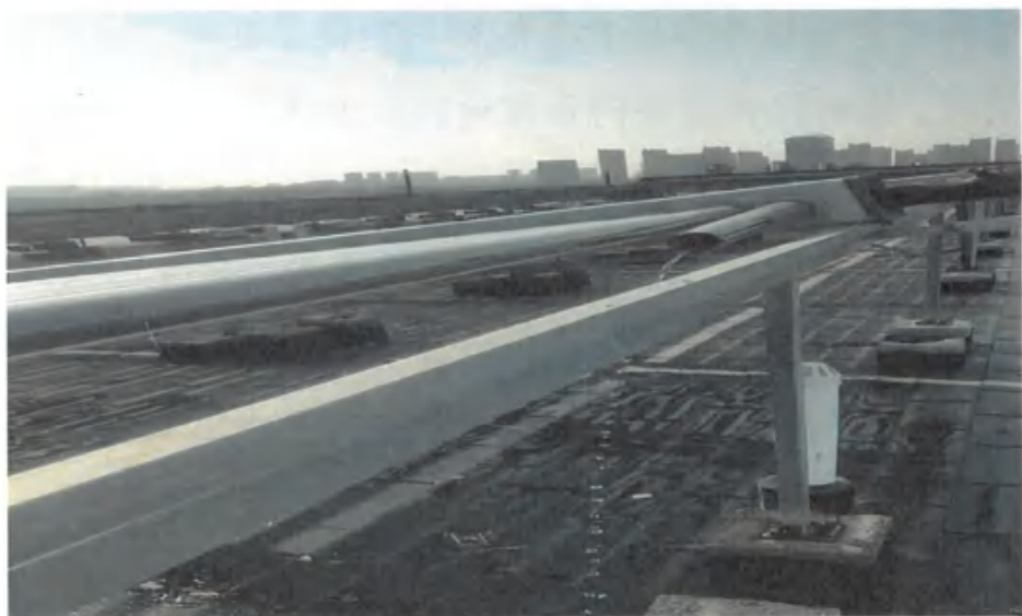
图 29：宿舍楼光伏设施设备
